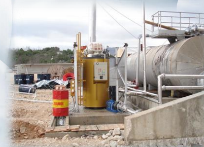
HIDROELEKTRA NISKOGRADNJA VKS 400 1 x 400 kW
